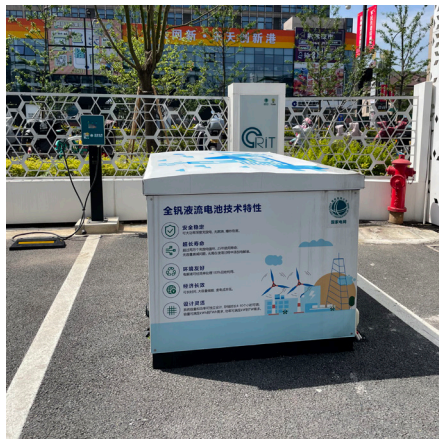
杭州某园区的光伏围墙及储能电池
